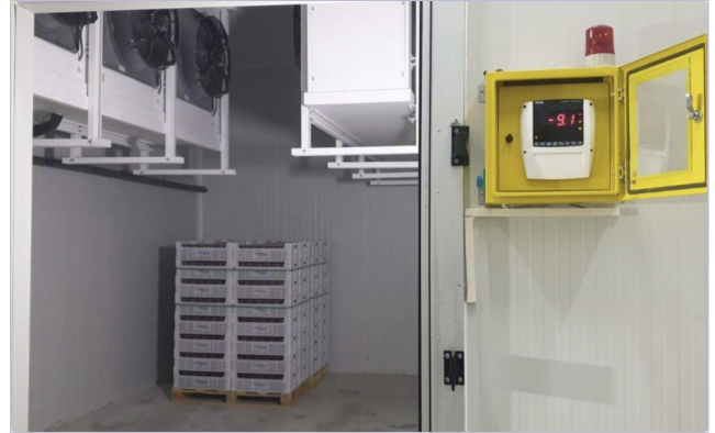
İşletmedeki soğuk oda ve kontrol paneli
