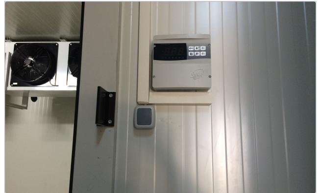
Kapı ve oda kontrol paneli
